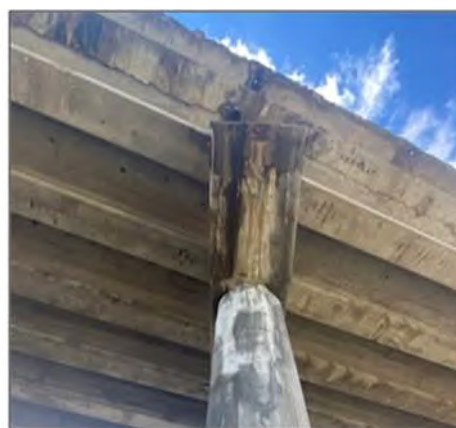
Замокание бетона балок, ригеля, столба размораживание бетона балок
