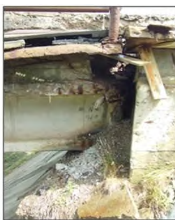
Замокание и размораживание бетона торца балки
