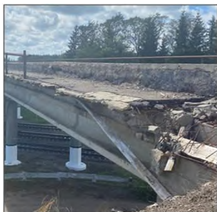
Сквозное разрушение тротуаров, отсутствие перильного ограждения
