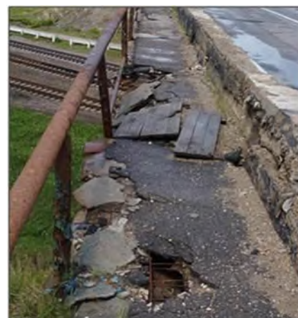
Сквозное разрушение тротуаров
