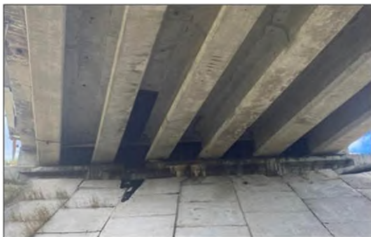
Замокание и размораживание бетона ригеля
