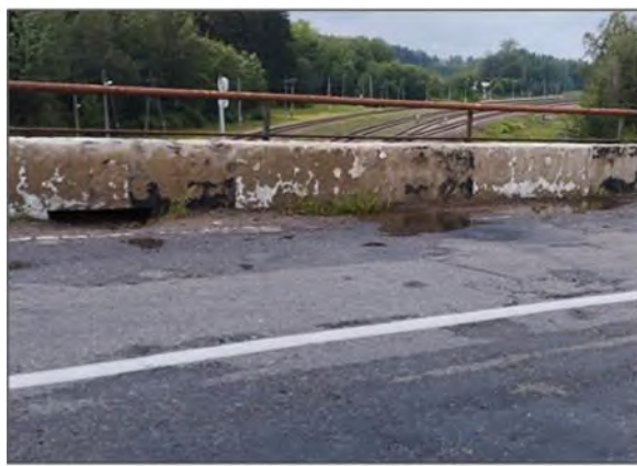
Ямочность, застой воды, мусор, размораживание бетона парапетного ограждения
